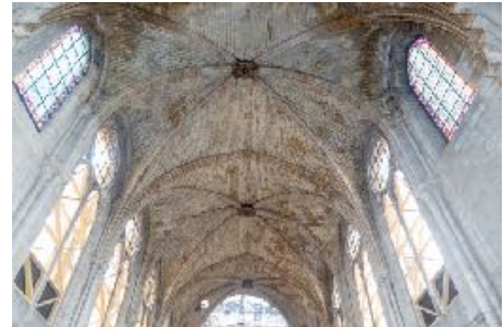
Dégâts de l'eau sur les voûtes de la nef
