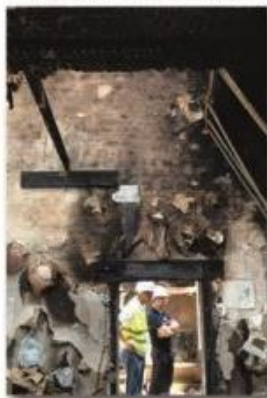
Origine du feu dans le comble
